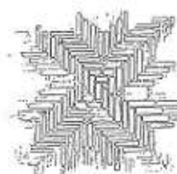
Voûte de la cave du château, aile gauche : deux lignes de briques s'entrecroisent formant les arêtes. Le reste de la voûte est constitué de briques disposées parallèlement à la ligne de fuite.
